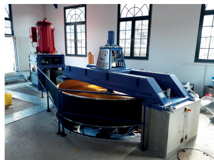
Riemenantrieb mit Generator 2 x 400 kW
